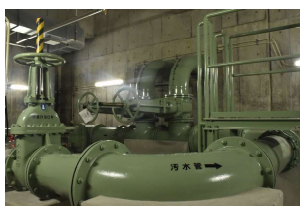
【配管室（地下1階）】
