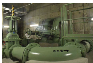
【配管室（地下1階）】
