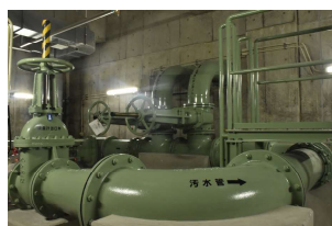
【配管室（地下1階）】
