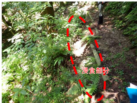
図 48. 小規模な法面浸食の例
