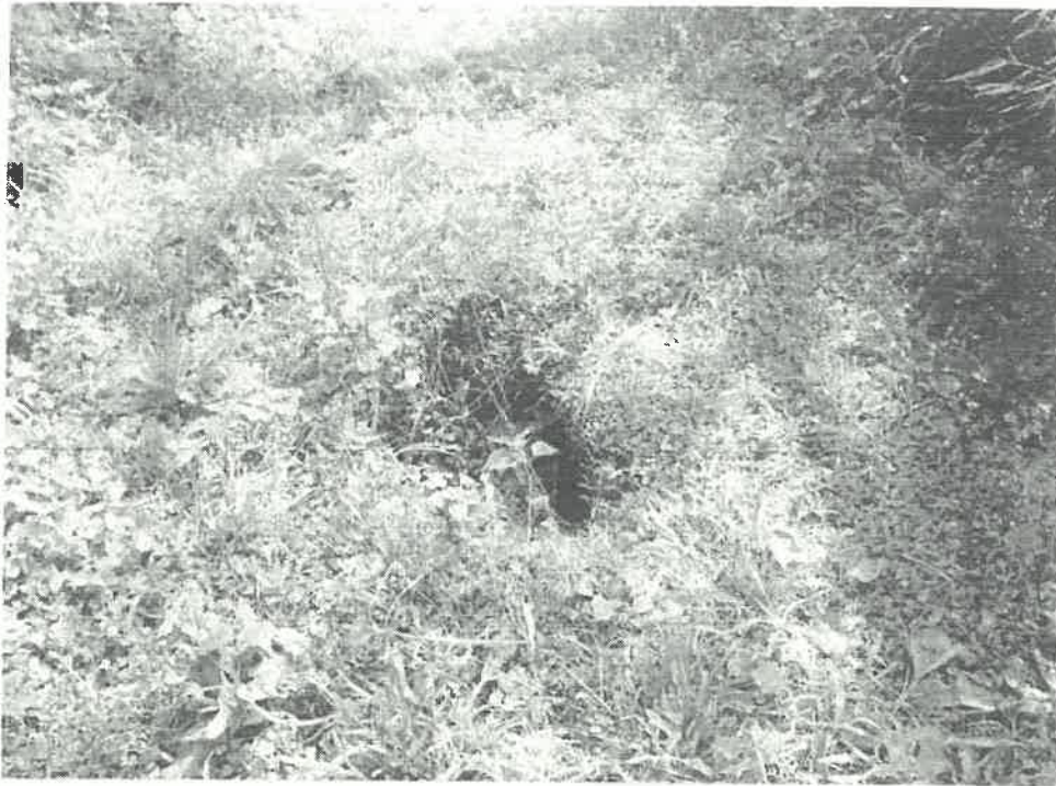
3, 町道に穴が開いている
