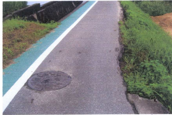
・この付近は路肩が落ち、白線の内側は1.5mしかない ・8月に乗用車が入り込みJAFが引き上げる
