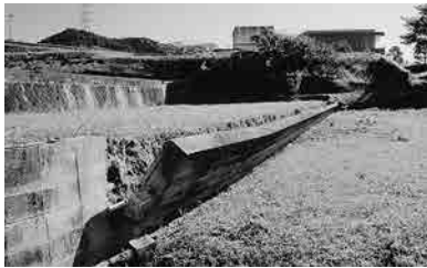
▲大雨による町内の被害
