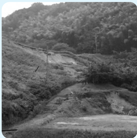
堤防の一部が地滑りを起こした亀の甲ため池鳥栖筑紫野道路も、一時通行止めになった
