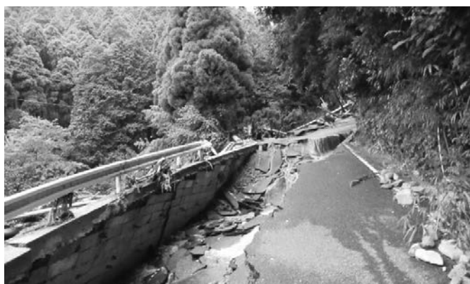
▲基肆城史跡（水門跡）への町道が崩壊
