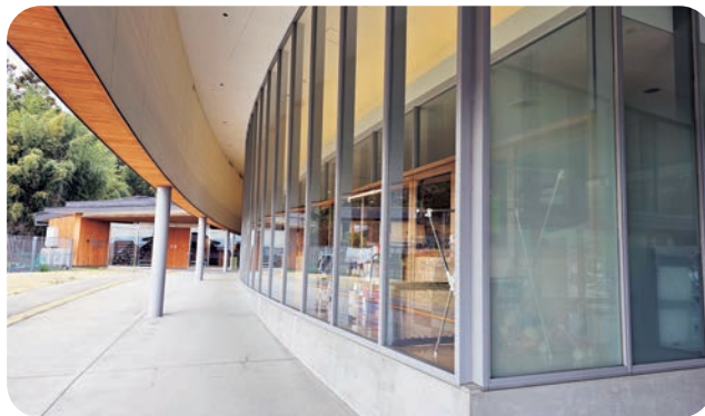
門扉（左）・非常口（右）が無く セキュリティ上に問題が
