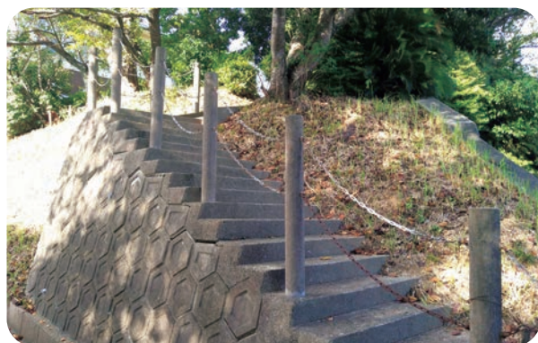
チェーンの手すりは危険
