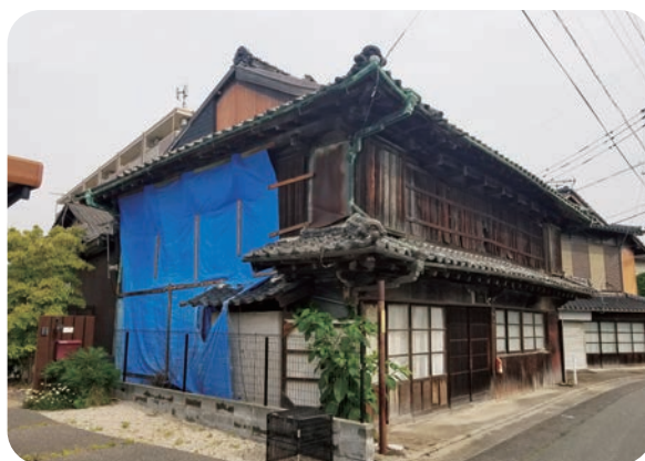
危険な空き家、早急に撤去を
