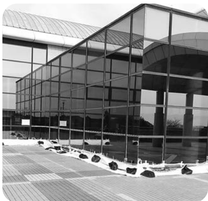
町民会館は早急な漏水対策が必要
