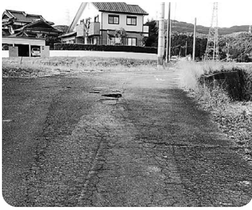
舗装整備が待たれる生活道路
