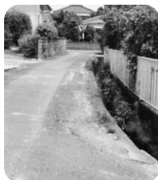
舗装が劣化した町道長野2号線
