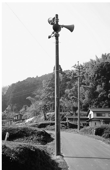
▲防災無線施設
